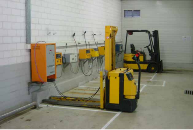
Abb. 3: Brandschutztechnisch gute Lösung zur Aufstellung und dem Betrieb von Batterieladestationen
