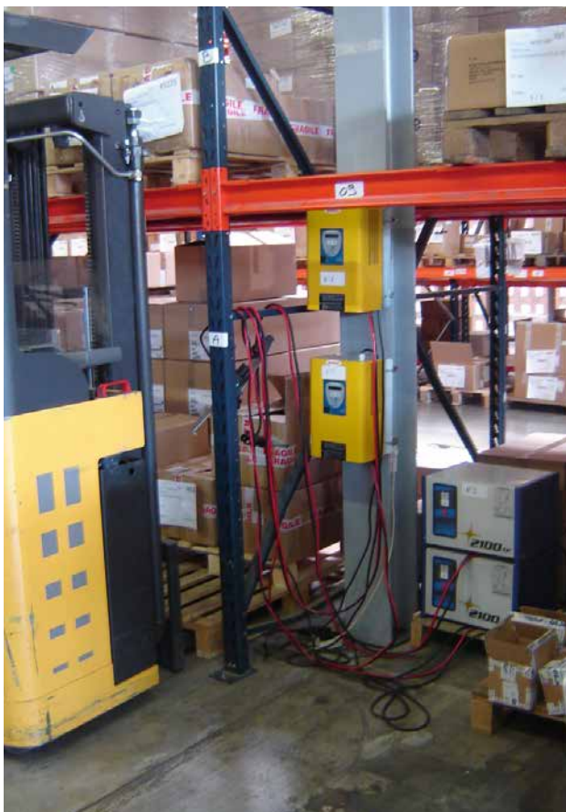
Abb. 1: Ladegerät in einem Regalfach. Auffällig sind die fehlenden Sicherheitsabstände des Batterieladegerätes zu brennbaren Stoffen und die Aufstellung des Ladegerätes auf einer Holzpalette. Darüber hinaus sind die Stromkreise nicht über Fehlerstromschutzschalter (RCD) geschützt.
