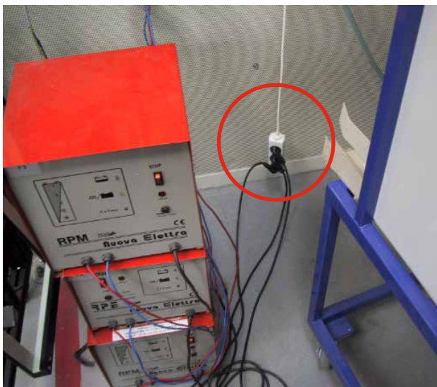
Abb. 2: Elektrisch und mechanisch über-/belastete Steckdosenleiste
