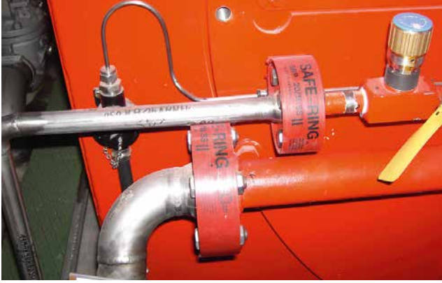
Abb. 2: Spritzschutzmanschetten an Ölleitungen
