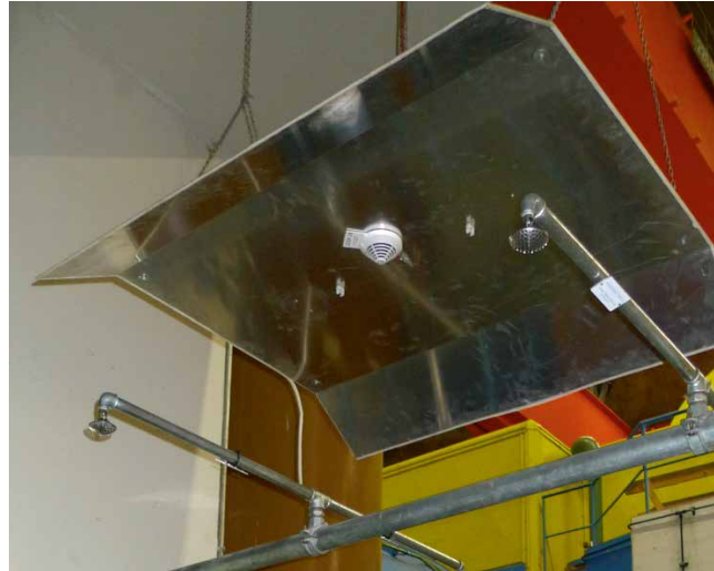
Abb. 7: Brandmelder mit Rauch- und Wärmestablen
