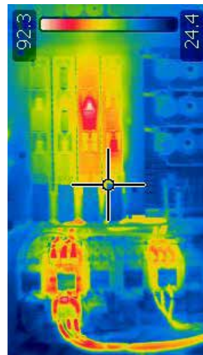
Abb. 2: Abgangsfeld NH Sicherungen
