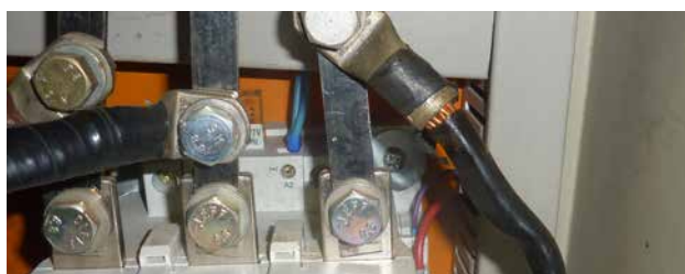
Abb. 1: Klemme Lastschalter, keine ausreichende kraftschlüssige Verbindung
