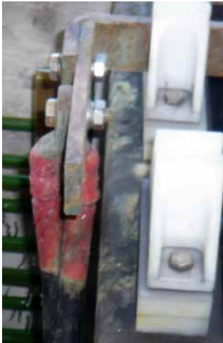
Abb. 5a und b: Elektroden mit Korrosionsschäden.
