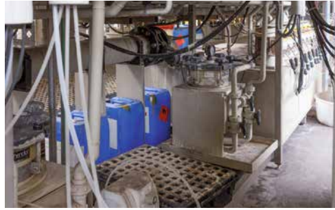
Abb. 10a: Offene Lagerung von brennbaren Chemikalien und Lösemitteln kann einen zusätzlichen Beitrag zur Brandausbreitung beitragen und sollte grundsätzlich vermieden werden.
