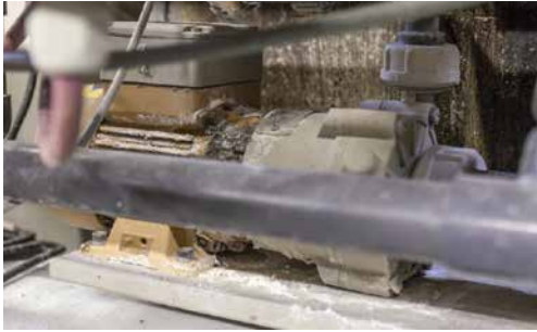
Abb. 9: Salzablagerungen an den metallischen Gehäusen der elektrischen Betriebsmittel führen sowohl zu einer beschleunigten Korrosion als auch zur Überhitzung durch Einschränkung der Kühlung.
