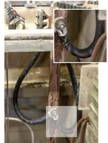
Abb. 5c: Elektroden mit nicht vor-schriftsgemäßer Installation (geknicktes Kupferkabel).
