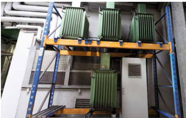
Abb. 8: Vier Gleichrichter a 8 V 600 A mit 215 kg Öl zum Kühlen. Durch die fehlende feuerbeständige Abtrennung der Gleichrichter liegt die Gefahr eines Brandüberschlages in angrenzende Räume vor. Zusätzlich besteht beim Aufstellen und Betreiben der Gleichrichter in Regalen die Gefahr einer Unterfeuerung. Die Gleichrichter sollten deshalb ebenerdig und mit einem Mindestabstand von 2,5 m voneinander sowie frei von Brandlasten aufgestellt und betrieben werden.
